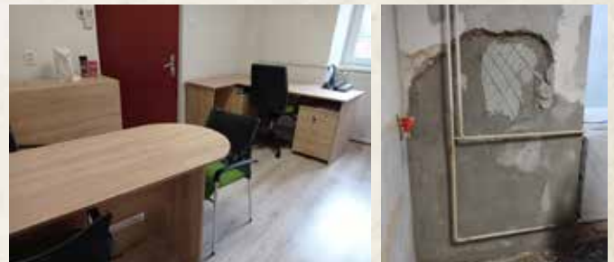
Obnova riaditeľne ZŠ (vľavo) a riešenie havarijného stavu na potrubí v MŠ (vpravo)
