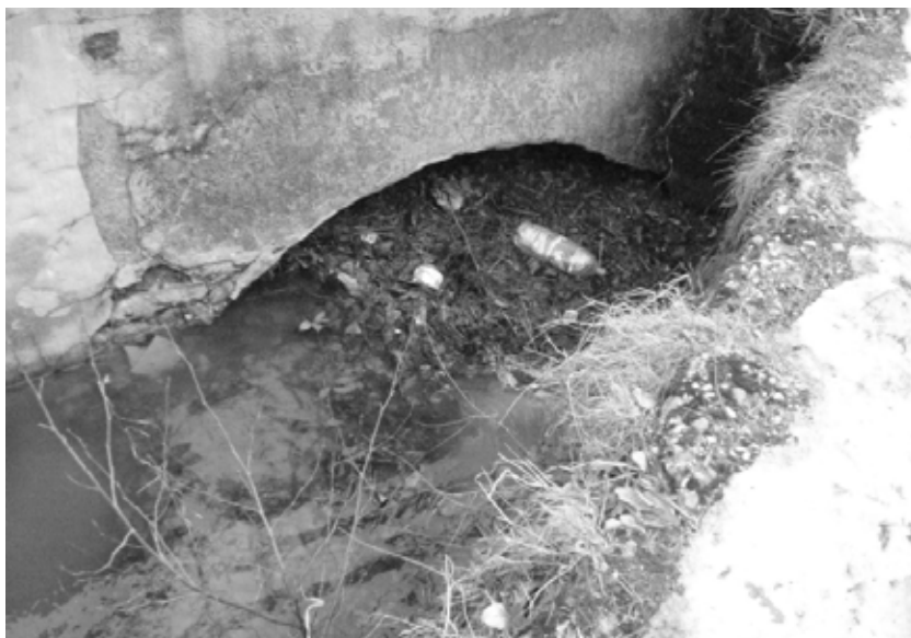
Takto to vyzeralo pred povodňou na moste č.79.
